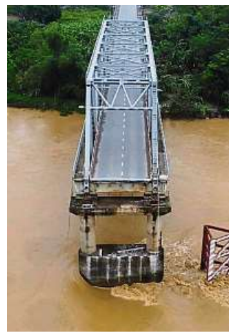
Die Phong-Chau-Brücke nördlich von Hanoi ist eingestürzt. Foto: dpa
