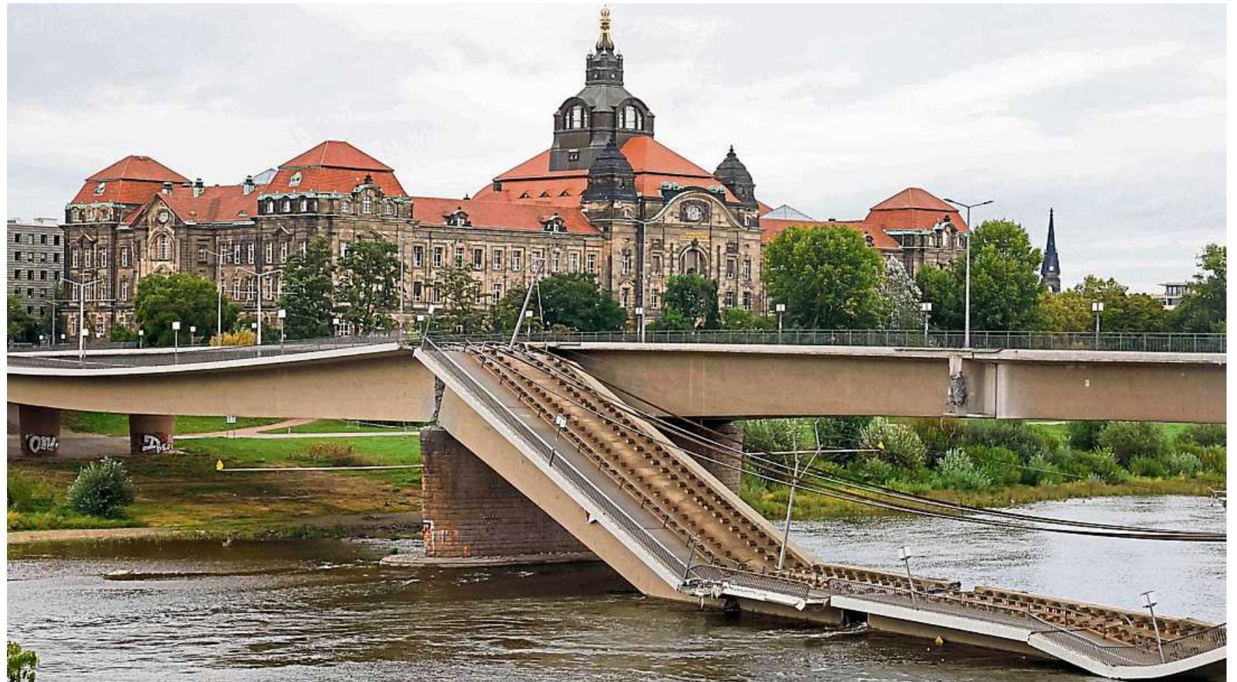
Die Carolabrücke ist eine der Hauptverkehrsadern in Dresden. Bei dem Einsturz des Brückenteils ist glücklicherweise niemand verletzt oder gar getötet worden. Foto: epd
